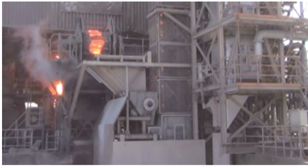
写真4 熱回収設備の運転状況 Photo 4 Operation of slag heat recovery plant
