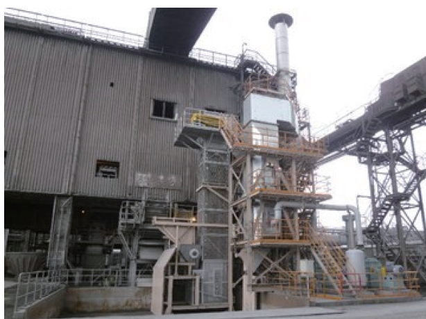
写真2 スラグ顕熱回収設備
